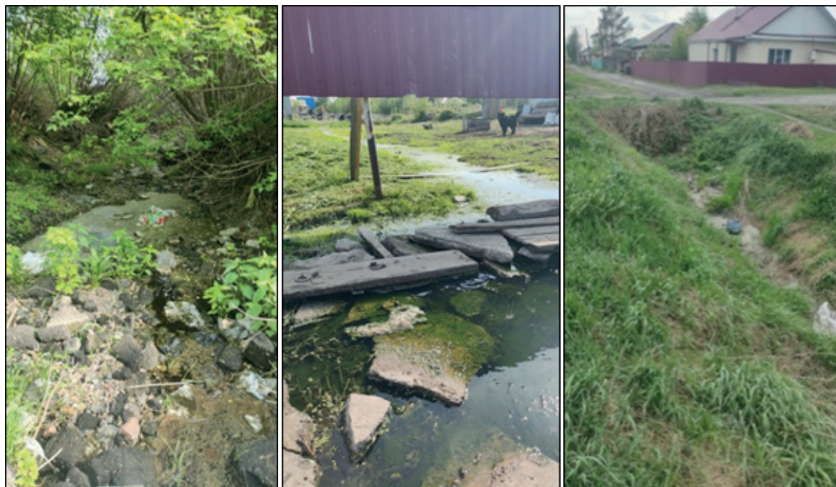
Рис. 1. Состояние некоторых элементов существующей дренажной сети (фото авторов)
